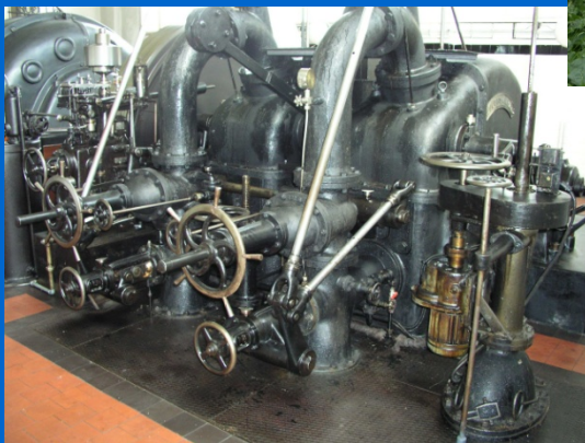
Bedřichov – mała elektrownia wodna Rudolfov I – historyczna turbina
